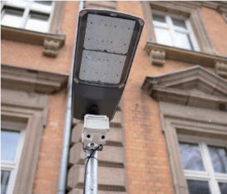
Intelligente Straßen- beleuchtung
